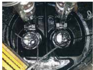
マンホールポンプ
