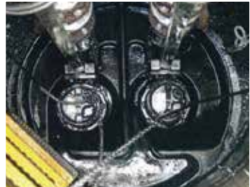
マンホールポンプ
