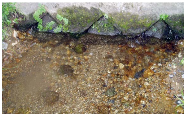
OK-3 落合川下流 落合橋直下右岸護岸隙間
