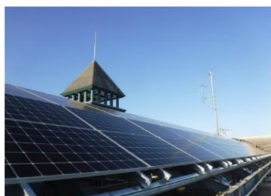
太陽光パネル
