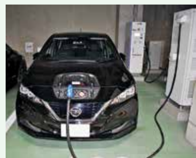
電気自動車から非常用電源設備への充電の様子
