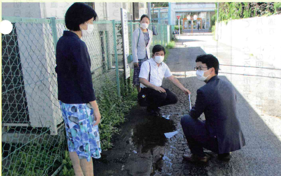
老朽化した生活道路を調査する共産党市議団。左から、永田まさ子、かもしだ芳美、北村りゅうた、村山順次郎。共産党市議団は生活道路の舗装等の改修促進に取り組んでいます。=南沢4丁目、8月19日
