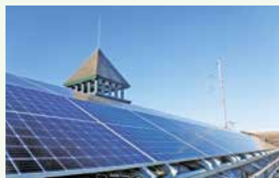
市役所本庁舎屋上の太陽光パネル
