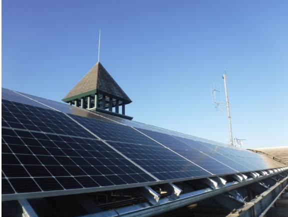
【屋上の太陽光パネル】
