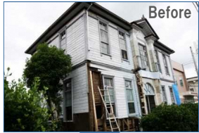
空き家の活用
