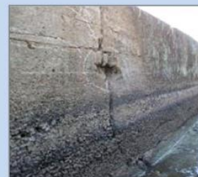
摩耗による骨材の露出
